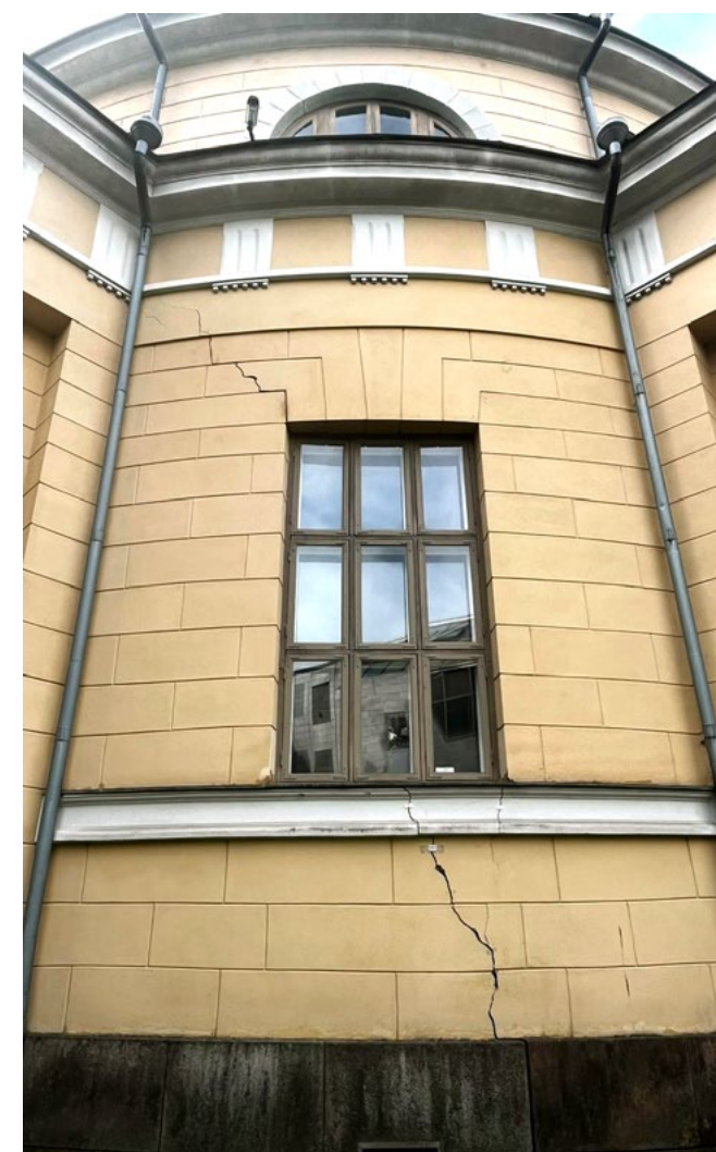
Kirkon ulkoseinän halkeamia. Kuva: Vera Nazimova.
